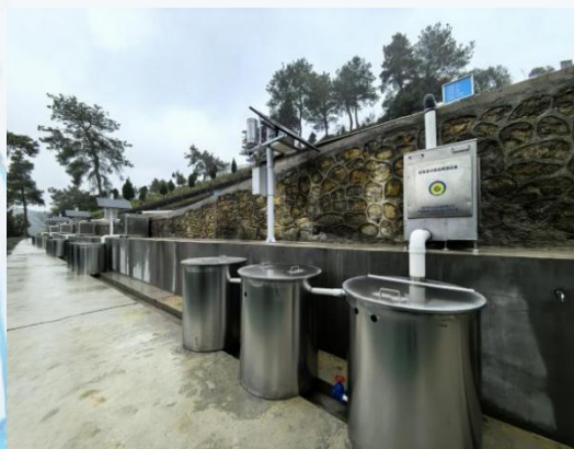
国家水土保持监测站点优化布局工程建设的自动化监测设备
